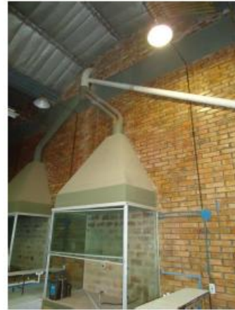
Campana extractora de gases
