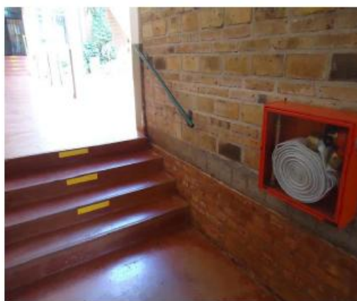
Boca de Incendio Planta Baja
