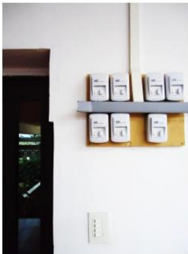
Llaves de encendido de luces y ventiladores aula A1
