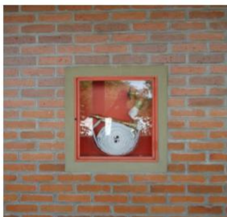
Boca de Incendio 2º Piso
